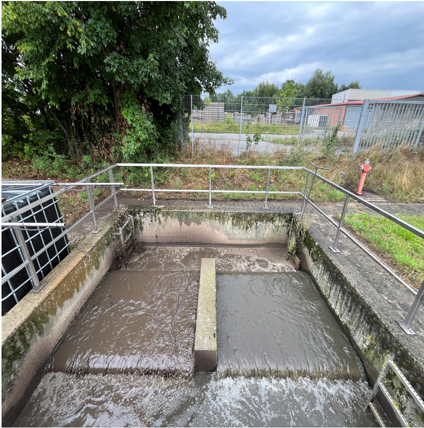
Abbildung 7: Zulauf Abwasser und Rücklaufschlamm-Verteiler (vor Belegung 1 und 2)
